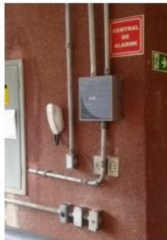
Central de alarmes
